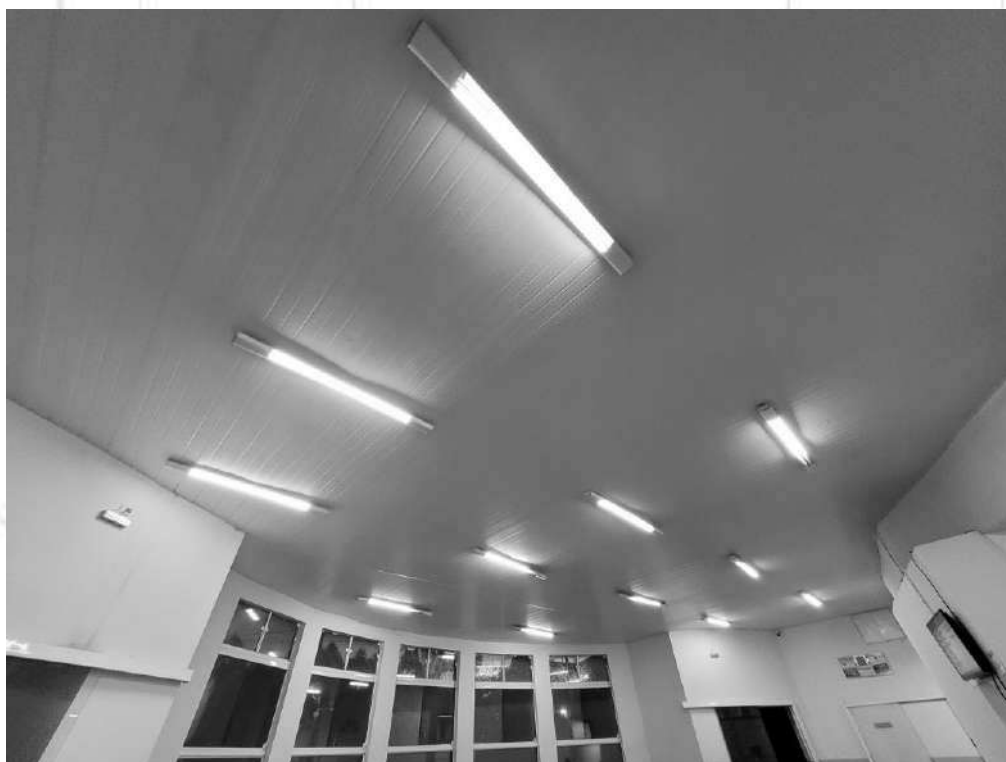
FOTO 22. Vista para troca das lâmpadas danificadas.
